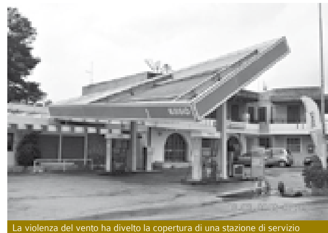
La violenza del vento ha divelto la copertura di una stazione di servizio
