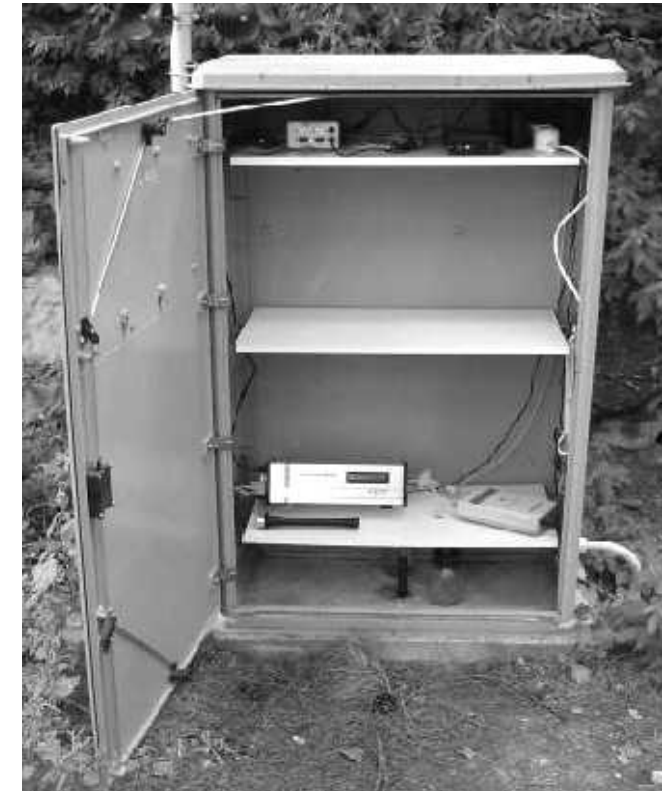
<<Stazione di rilevamento di gas radon>>
