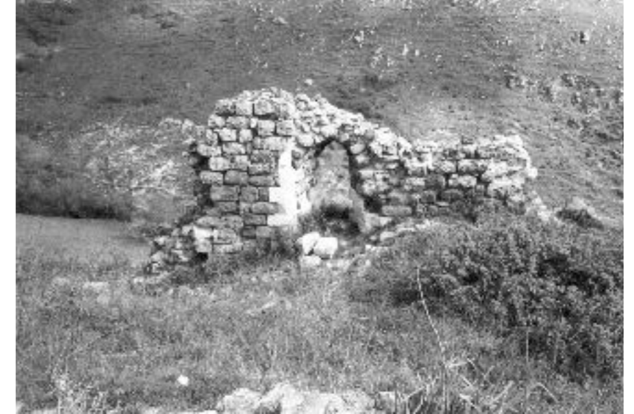
<Terravecchia. Un tratto delle mura di fortificazione del castello con una feritoia>
